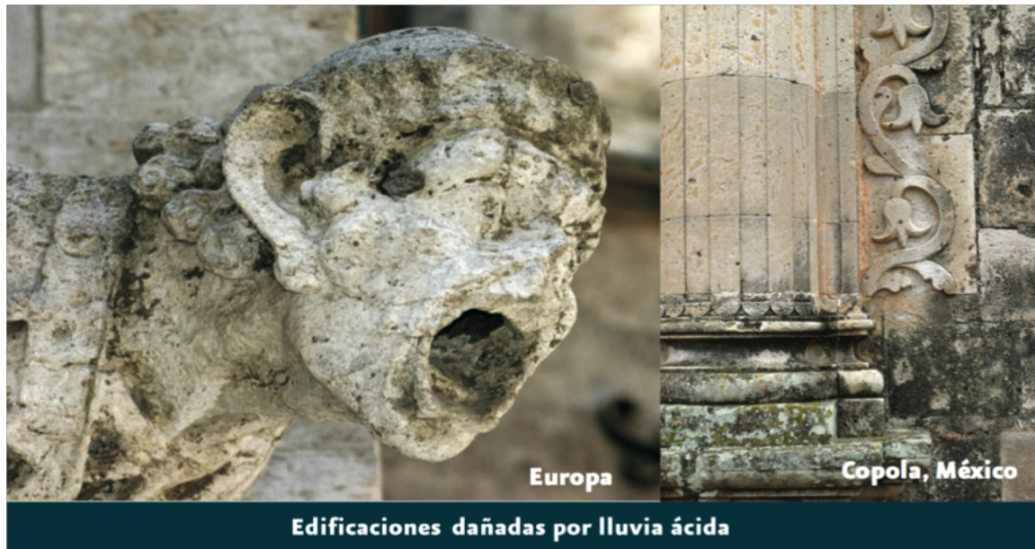
Figura 2.10: Daños en edificaciones por lluvia ácida.
